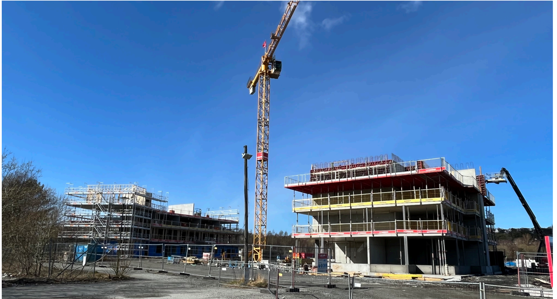
BYGGETRINN 1 BEGYNNER Å TA FORM: Det skal bygges i tre byggetrinn og første byggetrinn består av 51 boliger og blir innflytningsklare vår eller sommer neste år. Foto: Grethe Eriksen
